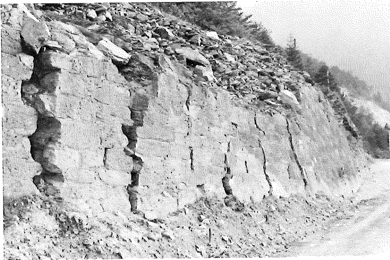
PHOTO 2. — Versant de rive gauche de l'Arc au-dessus de Modane-Fourneaux vers 1150 m d'altitude. La poussée du terrain s'exprime ici par les lézardes du mur de soutènement. A quelques centaines de mètres de là la Porte Monumentale de l'ancien tunnel ferroviaire du Fréjus s'est effondrée dix ans après sa mise en service.
